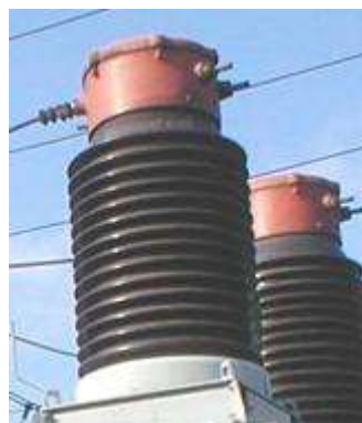
Fig. 2 - Transformatoare de măsură de curent
